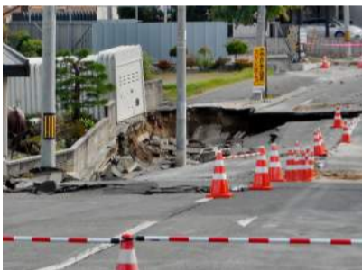
図1： 里塚1条2丁目 陥没箇所
