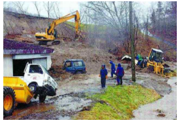
2010年の地震で崖崩れした清田区のゴルフ場 (2010年12月3日北海道新聞夕刊13面より)
